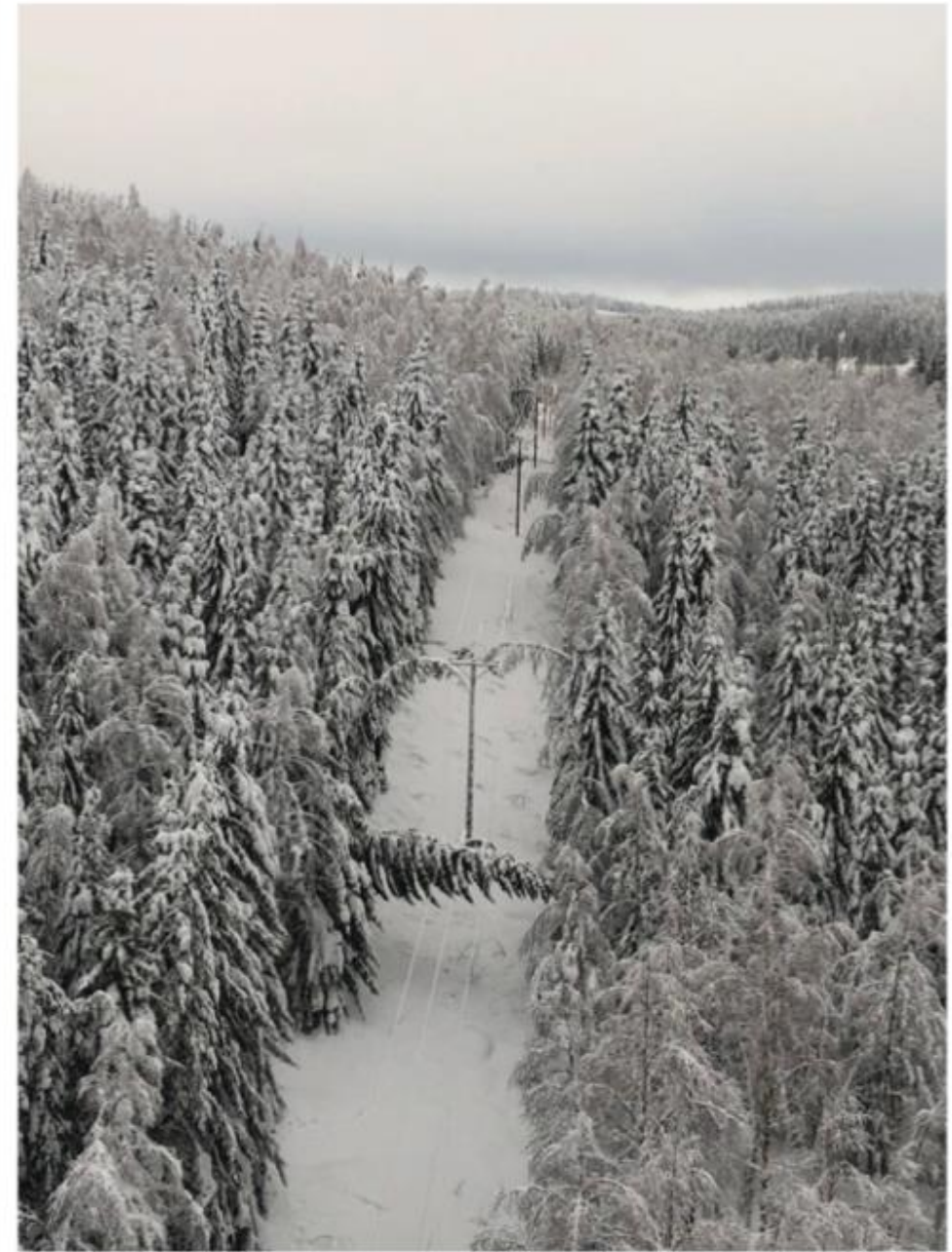
Kuva: Pohjois-Karjalan sähkö
